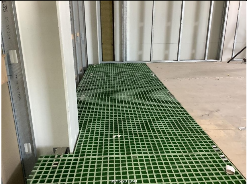
CLT GRP riser infill
